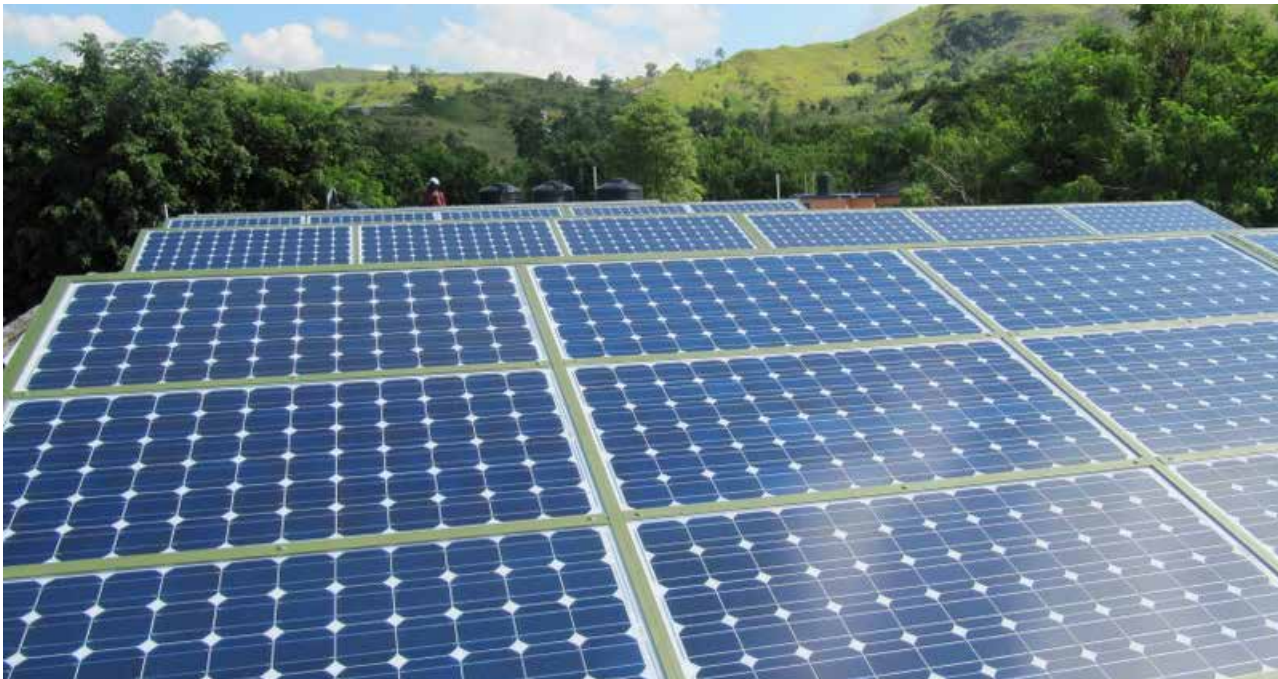
Paneles solares a escala comunitaria en el área rural de Haití. Foto cortesía de Sun Energy Power International.
