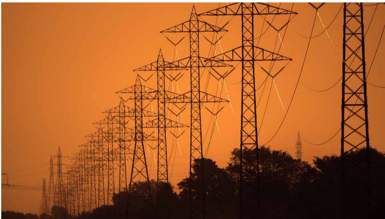
Fila de torres eléctricas que transmiten energía hidroeléctrica en Quebec, Canadá. Foto cortesía de Google Images.
